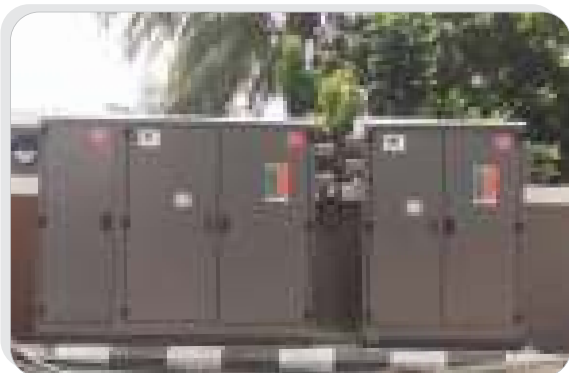
11kV Motorised RMU
